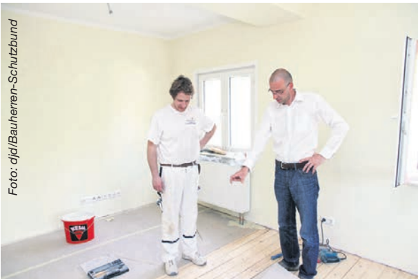
Foto: djd/Bauherren-Schutzbund Mit einer baubegleitenden Qualitätskontrolle lassen sich Planungs- oder Ausführungsfehler bei Modernisierungen in der Regel rechtzeitig erkennen und beheben.
