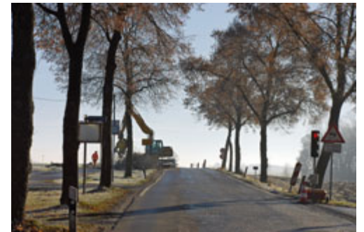
Die oberen Riesen sind schon gefällt; der Bautrupps arbeitet von oben nach unten zur Schlosseinfahrt
